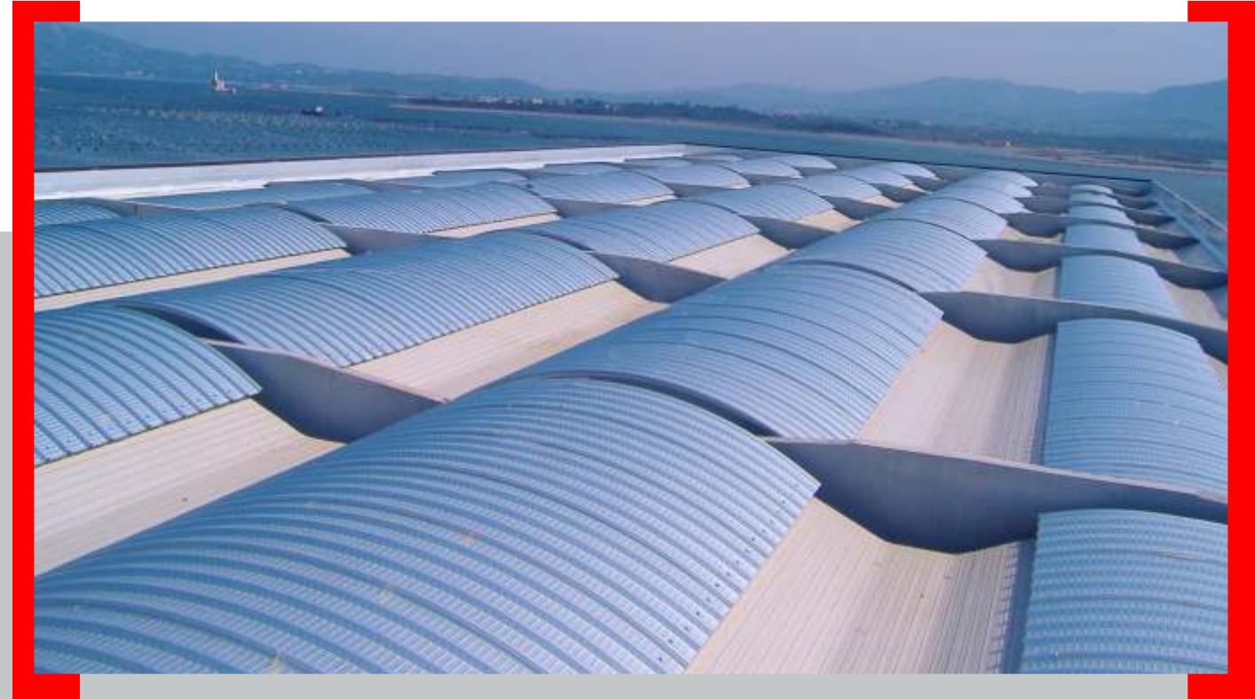
Immagini in basso: Silver con impermeabilizzazione in lamiera
